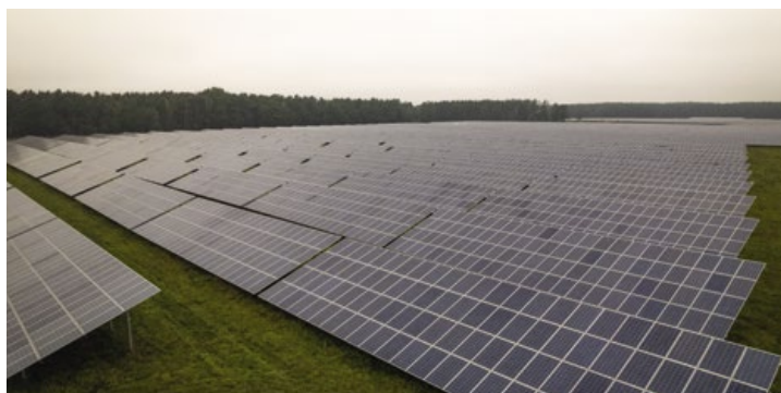
Sonnenenergie aus der Lausitz: Arnd von Moers, Projektleiter, und Monika Hentze, Leiterin PV-Anlagen, bei einem des Solarparks Laubsdorf II.
